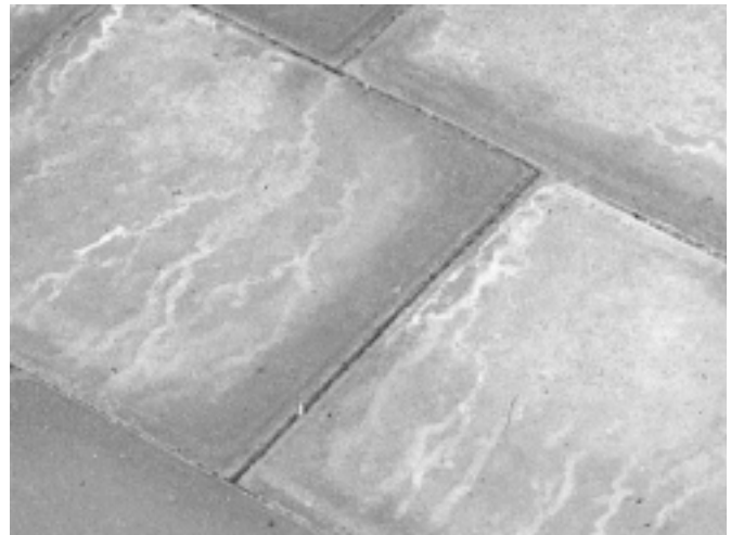
Bild 5: Ausblühungen nach 2 Monaten
