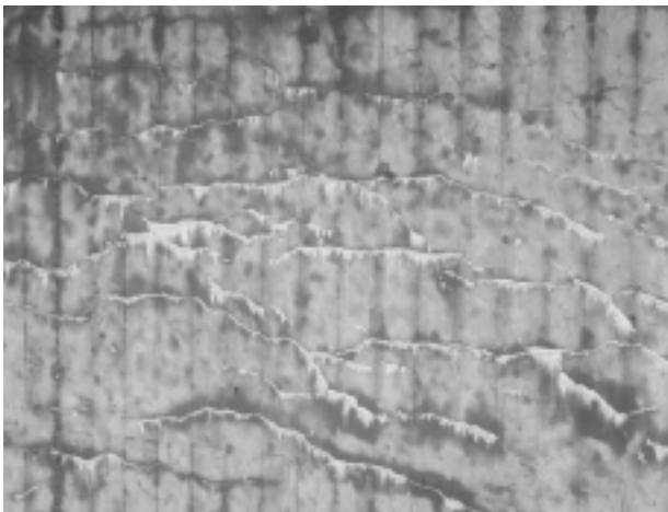
Bild 2: Ausblühungen und Aussinterungen an einer Brettgeschalteten Betonoberfläche
